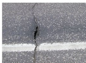
Fissure de fatigue dans un enrobé bitumineux.
