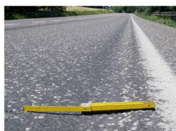
Orniérage d'un enrobé bitumineux.
