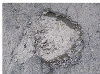
Désenrobage de granulats provenant de dégradations liées à la présence d'eau.
