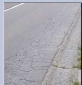
Fessurazione da invecchiamento
