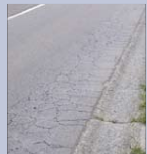
Rissbildung durch Oxidation
